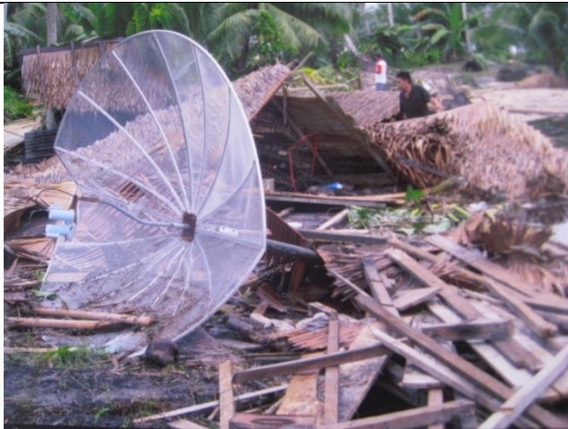
Struktur bangunan dari kayu yang sudah berupa puing (BMKG2010)
